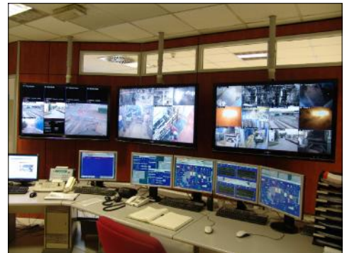
Sala di controllo
